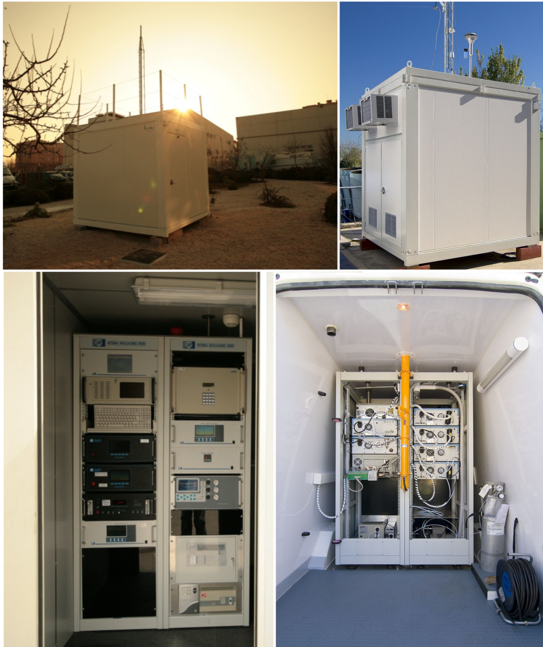
Figura 24. Cabinas de monitoreo equipos automáticos
